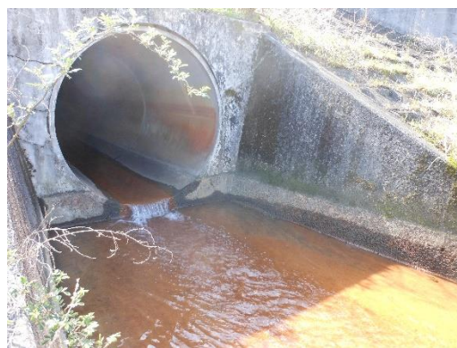
↑) 4/13, 東側流入口 側溝の水(雨水と湧き水)と工場排水
